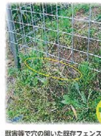
獣害等で穴の開いた既存フェンス
