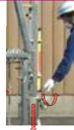
確認よいか... 安全ダンパーが下がっているか 赤いレバーを引くと下がる
