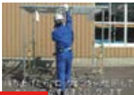
確認よいか... ロックピン固定固定音確認良いか
