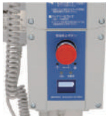
緊急停止ボタン
